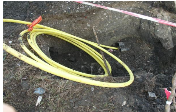
Foto 14. Subtraversare în zona stației Brazi – se observă cele trei țevi una ocupată cu conducta HDPE, celelalte două prevăzute pentru cablurile de semnalizare
