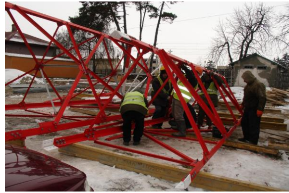
Foto 8. Se lucrează la montarea segmentelor turnului de antena GSM- R stația Periş
