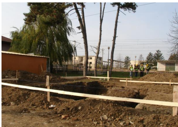
Foto 1. Săpături executate la fundația clădirii container pentru instalația electronică de semnalizare din stația Periș
