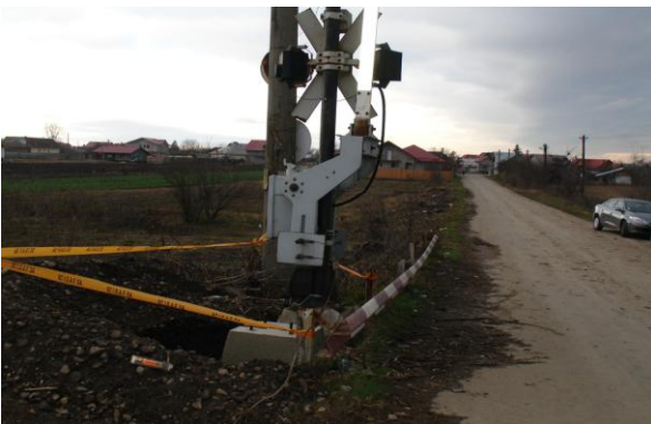
Foto 11. BAT Dîrza km.19+775 – mutare semnale avertizare rutieră și montare fundații noi pentru noile semnale de avertizare
