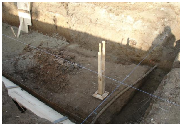
Foto 2. În ampriza fundației clădirii container se afla un cablu de telecomunicații funcțional. Acest cablu a trebuit deviat și scos din zona șantierului
