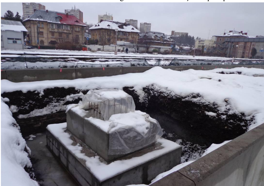
Copertină peron liniile 3 și 4 – Fundație stâlp copertină cu protejarea carcasei de buioane
