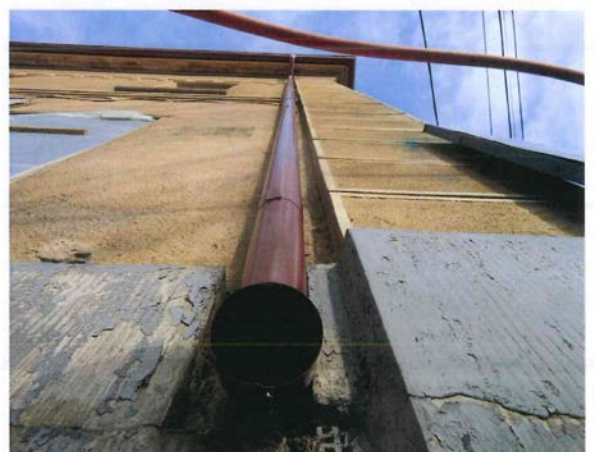
8. 30.01.2013-Sistem de scurgere a apelor (burlane) de pe acoperișul clădirii de călători
