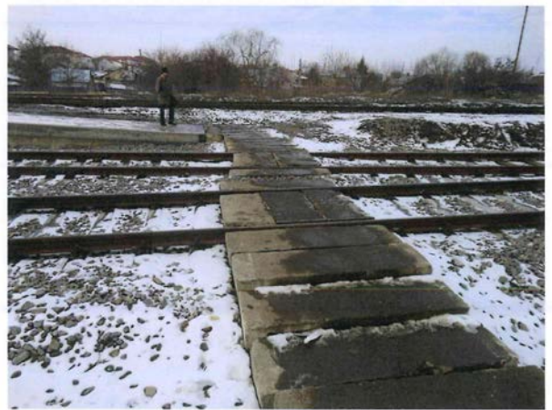
4. 30.01.2013-Amenajarea trecerii la nivel provizorie pentru accesul călătorilor în cap X al stației
