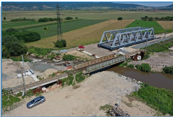
POD Cerna (km 477+301)
