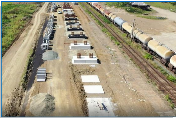
Rezistență – Stația Vărădia de Mureș
