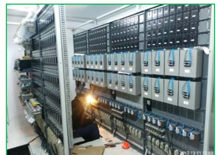
Vințu de Jos – instalație CE
