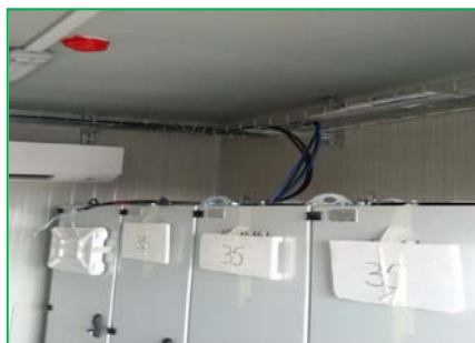
Tunel Turdaș GSM-R – instalare centrală energetică
