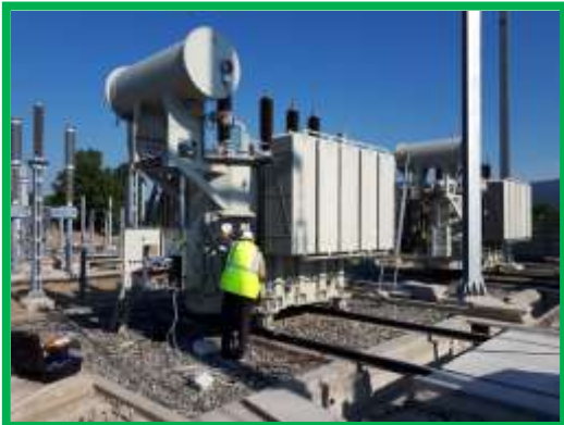
Teste SAT servicii auxiliare de alimentare la Substația Șibot
