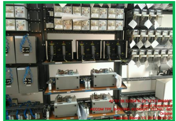
Stația Orăștie - echipamente și aparataj pentru circuite de cale
