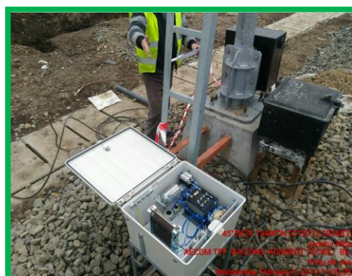
Stația Vințu de Jos - cutii cu aparataj pentru circuite de cale
