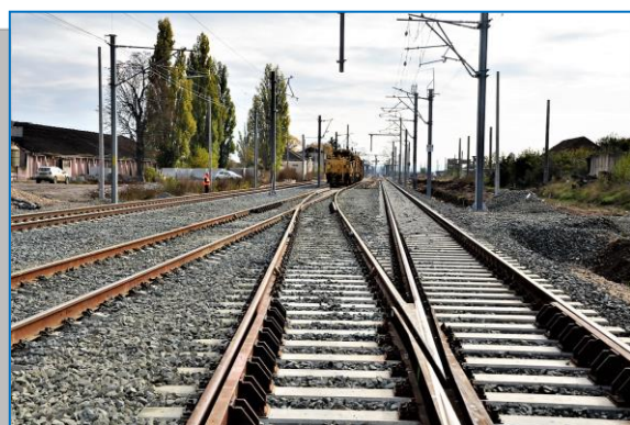
Stația Ghioroc – Schimbatoare de cale
