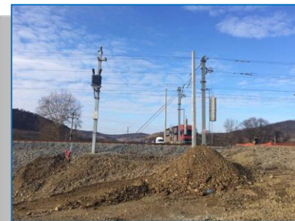
Stâlpi la trecerea la nivel, Mediaș - Copșa
