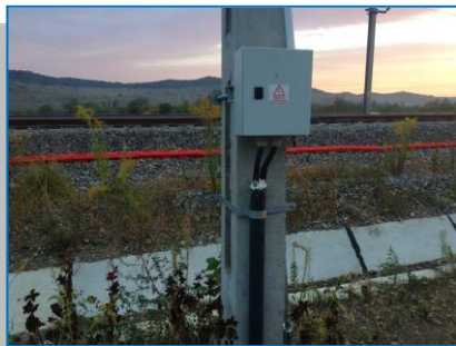
Stâlpi de iluminat – St. Daneș
