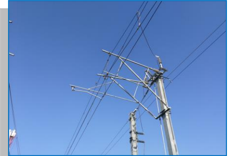
Crăciunel – Podu Mureș - legături în catenară
