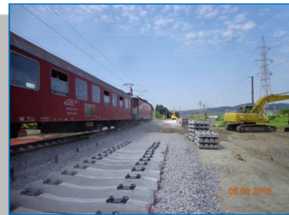
Suprastructură Fir I, Ațel - Mediaș
