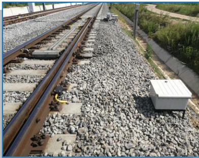
Stația Valea Lungă-încălzitoare macazuri
