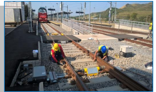
Stația Blaj-cutii pe șină și cutie cu transformator
