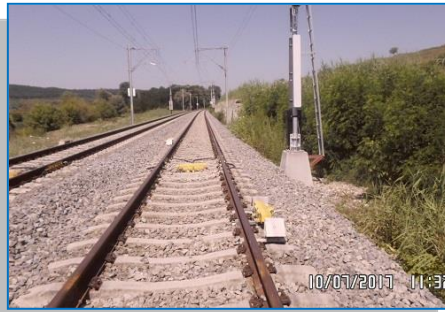
Valea Lungă – instalare cameră
