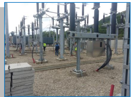
Substația de tracțiune Micăsasa
