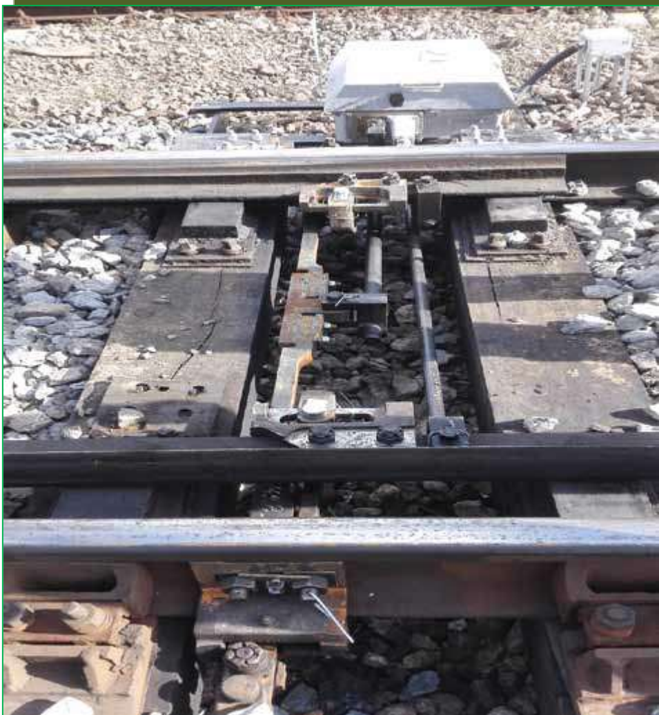
Instalații Centralizare Electronică – Macaz
