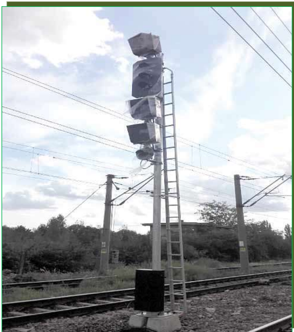
Instalații Centralizare Electronică – Semnale
