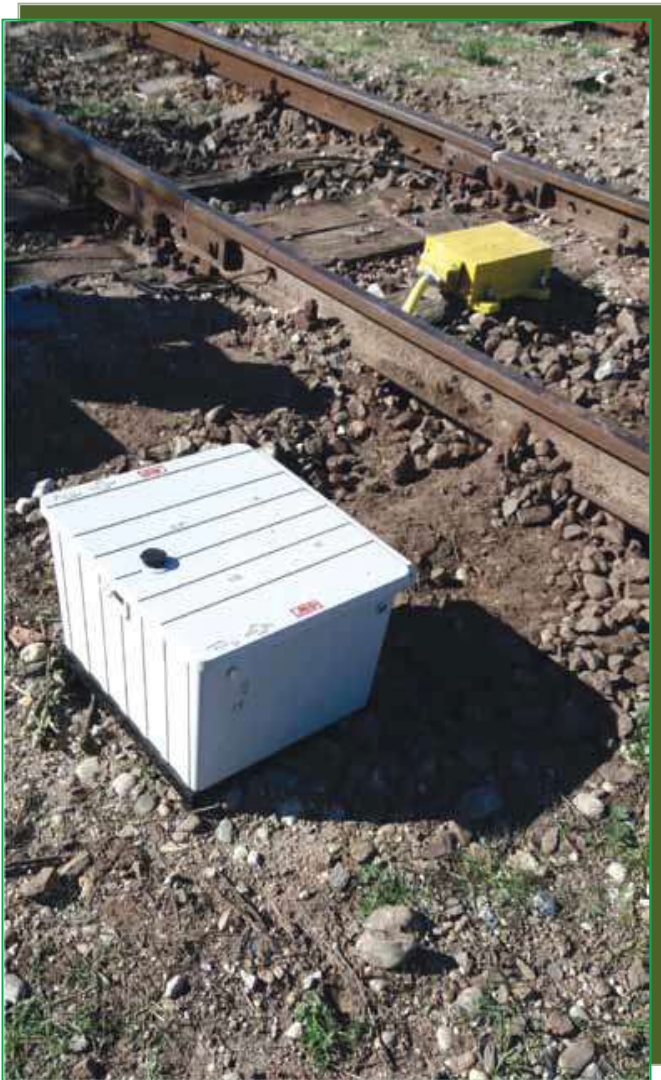
Echipament nou instalat: pichet cale
