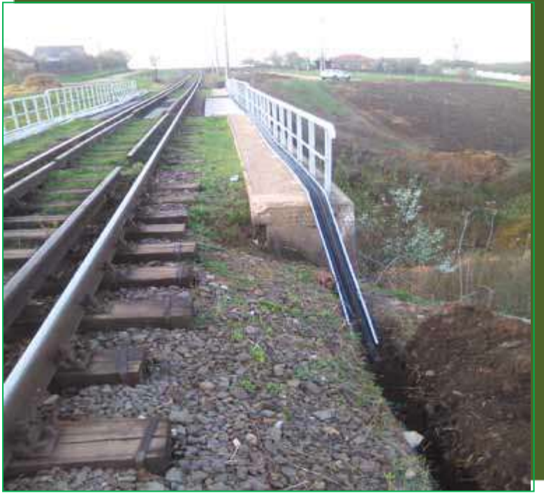
Pozare cabluri de semnalizare pe pod
