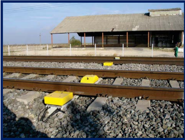
DCOS Bărăganu – Echipamentele din cale
