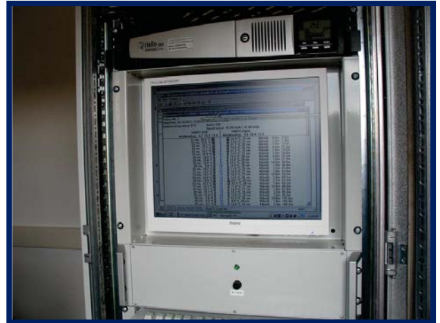
DCOS Bărăganu – Echipamentele interioare
