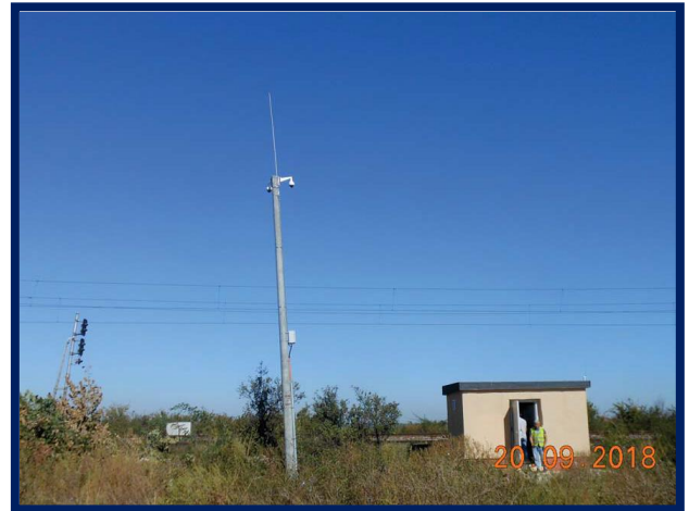
Teste la terminarea lucrărilor și verificări în vederea punerii în funcțiune DCOS Vadu Lat
