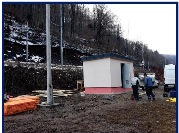
Instalații supraveghere video și clădire container aferent DCOS Valea Largă
