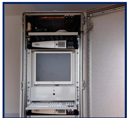
Echipment interior DCOS montat în clădirea container DCOS Grozăvești
