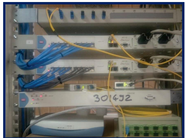
Echipamente de telecomunicații în Repartitorul TTR Filiași aferente DCOS Răcari
