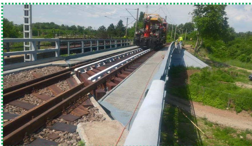
Verificări efectuate în vederea redeschiderii circulației feroviare
