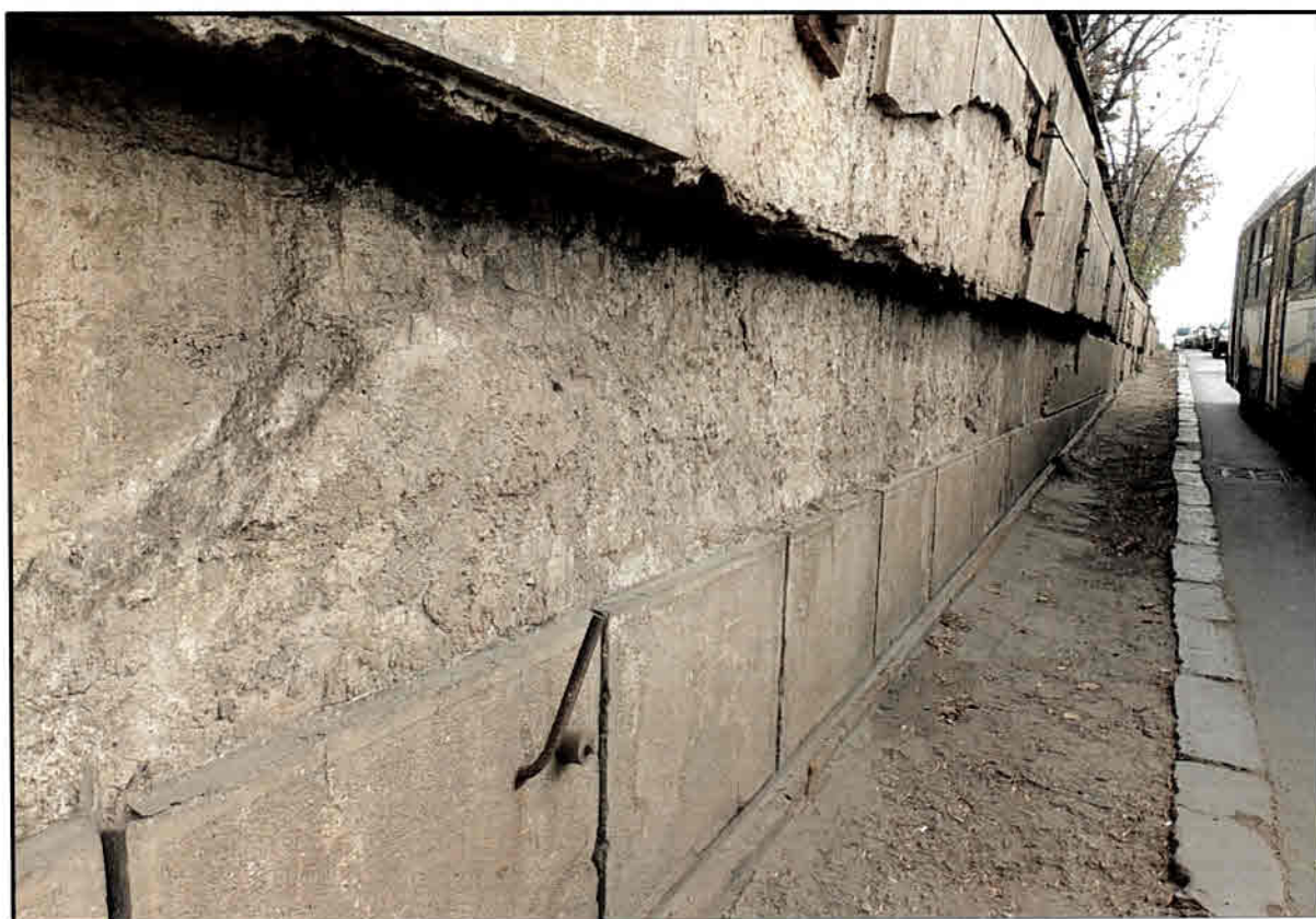
Foto nr. 10 - Elevația zidurilor de sprijin de pe rampele de acces este puternic degradata prin izbirea autovehiculelor
