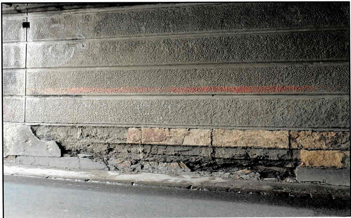
Foto nr. 7 - Culeele prezinta zone in care tencuiala este căzută, cu zone extinse de beton segregat si rosturi de tunare executate incorect
