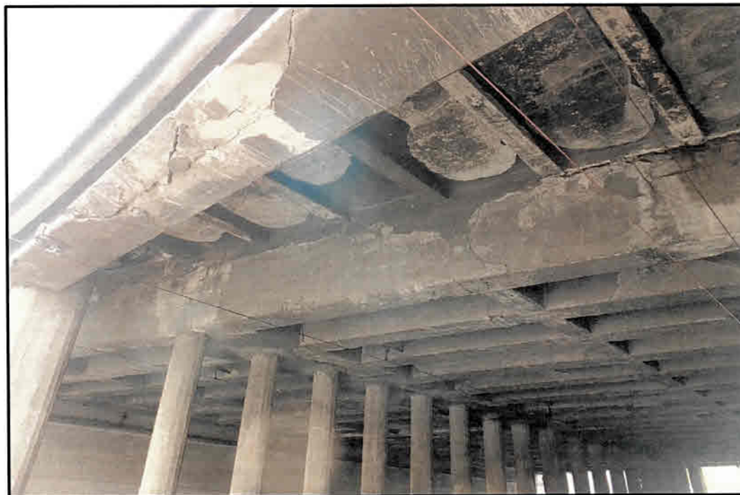
Foto nr. 1 – Ruperea betonului din talpa inferioară a grinzilor marginale
