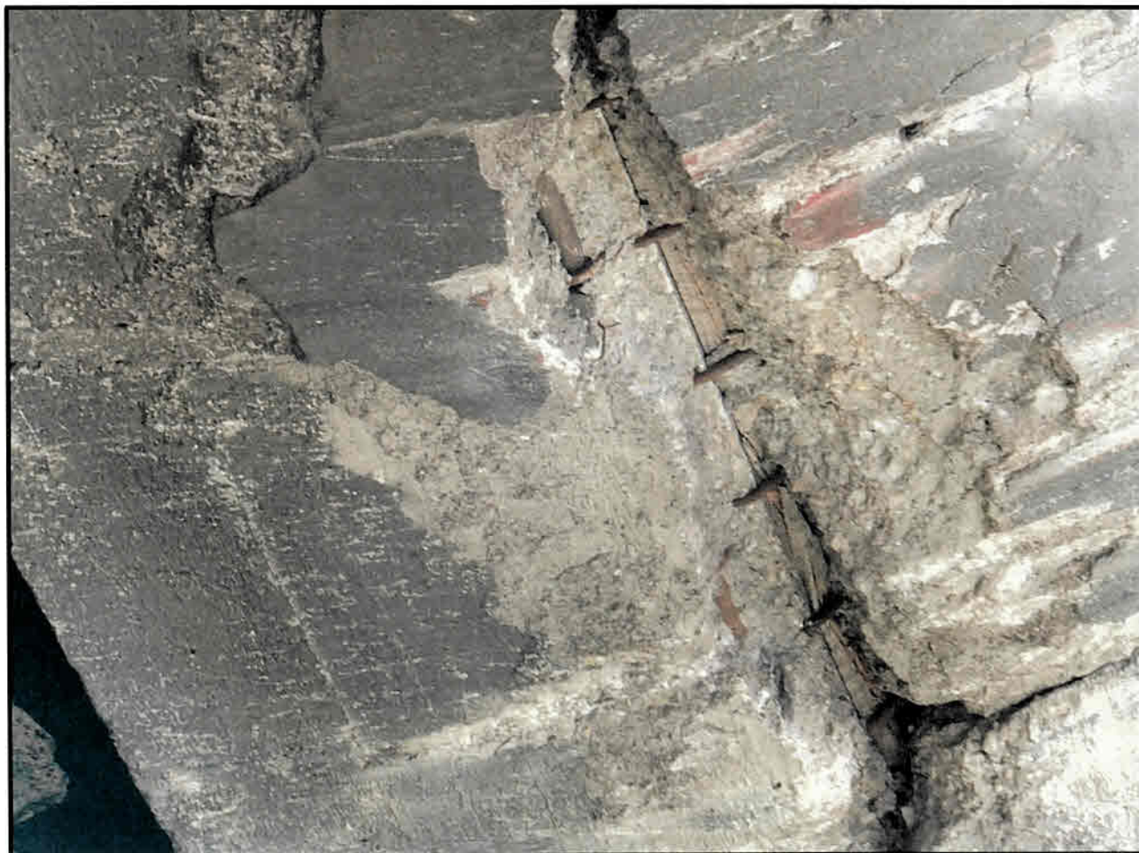
Foto nr. 2 - Infiltrații pe zone extinse, armături fără strat de acoperire, beton cu aspect friabil și zone din beton exfoliat și dislocat, la rostul longitudinal dintre cele doua tabliere care compun suprastructura pasajului
