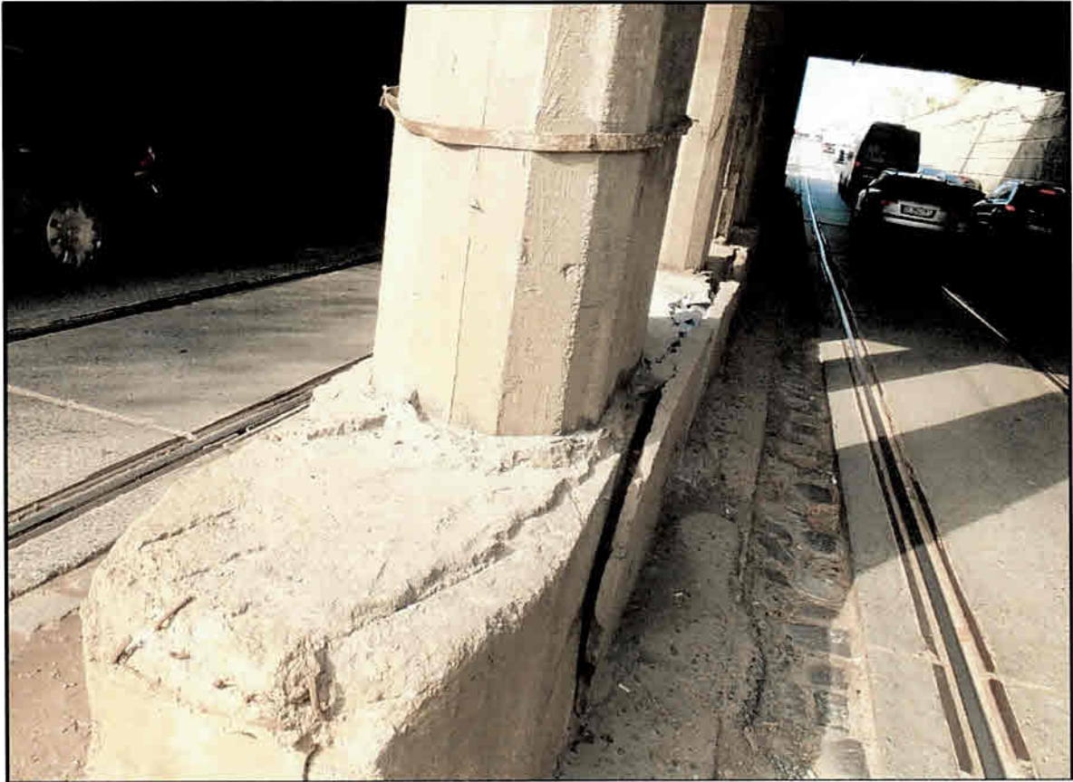
Foto nr. 6 - Soclul pilei prezinta degradări locale, fisuri, crăpături si betoane desprinse
