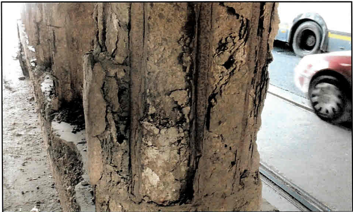
Foto nr. 5 – Fisuri, crăpături, striviri, exfolierea betonului, armatura la vedere, puternic corodata, la nivelul stâlpilor pilei
