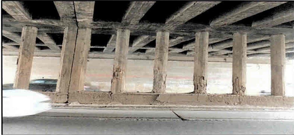
Foto nr 4 - Stâlpii pilei prezinta zone extinse cu beton segregat si dislocuit, fisuri si crăpături longitudinale, armatura de rezistenta puternic corodata, cu reducerea cu valori semnificative a secțiunii stâlpilor
