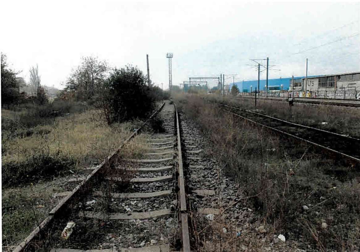
Foto nr. 8 - La liniile I, II, si III se constata o lipsa totala a lucrărilor de întreținere.
