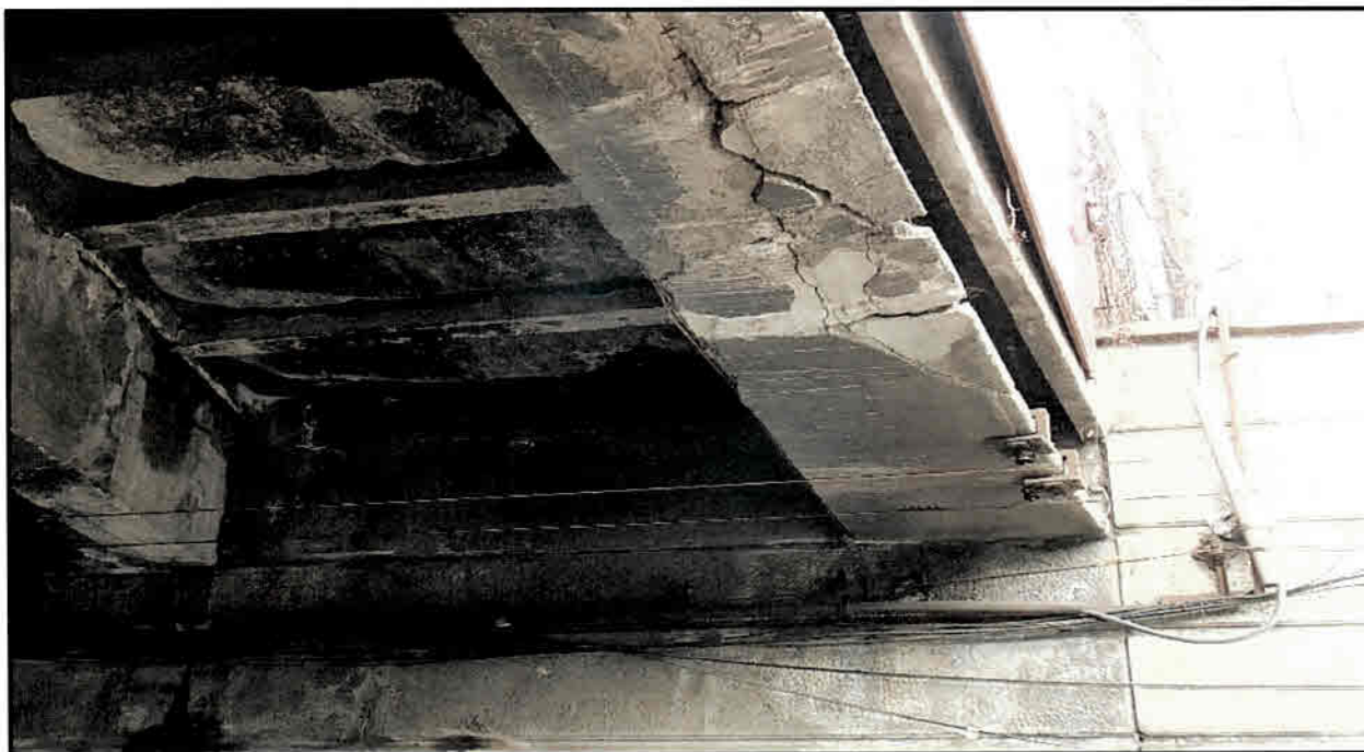
Foto nr. 3 - Cumularea la elementele suprastructurii (grinzi principale, antretoaze, placi) a mai multor procese de degradare degradări: coroziune, fisuri, crăpături, striviri, exfolierea betonului
