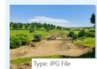
Type: JPG File Size: 85.7 KB Date modified: 31/01/2020 202106_Săpătură pentru platforma tehnologică coloane forate viaduct km 252+525
