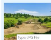
Type: JPG File Size: 85.7 KB Date modified: 31/01/2022 202106_Săpătură pentru platforma tehnologică coloane forate viaduct km 252+525
